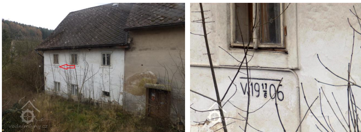
Obr. 4–4a. Povodňová značka ze 17. 6. 1906 na mlýně v Popovicích (celek a detail).
